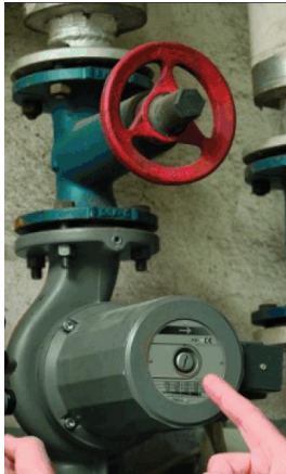
Bei alten Heizungspumpen lohnt sich der Austausch. Foto: ©Intelligent heizen/VdZ
